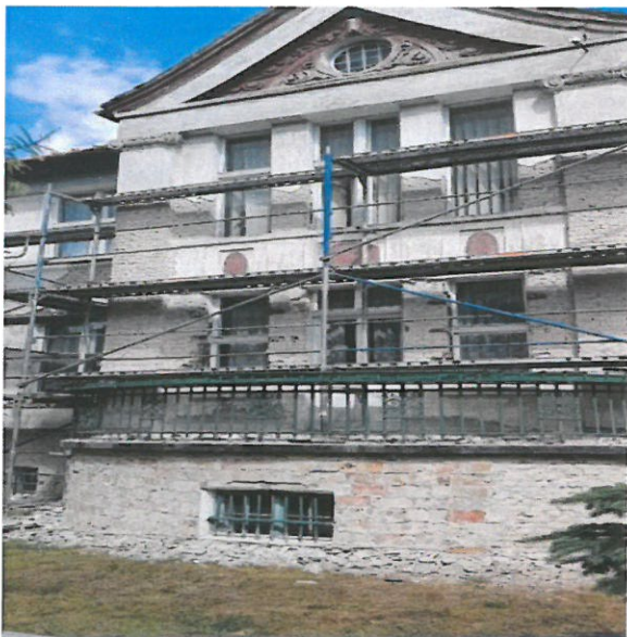
Budynek Poradni Psychologiczno – Pedagogicznej w Białogardzie w czasie remontu przeprowadzanego w ramach Regionalnego Programu Operacyjnego Województwa Zachodniopomorskiego w roku 2018
