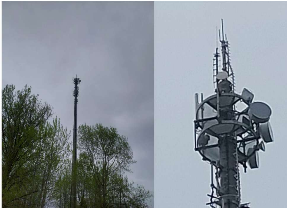
Widok obiektu wraz z zainstalowanym zespołem antenowym
