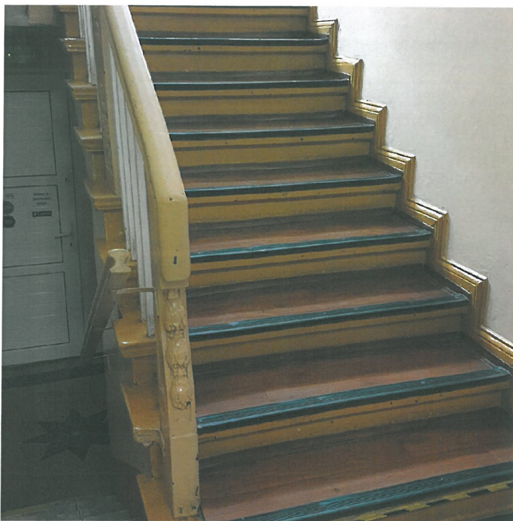
Fot. 2. Widok biegu klatki schodowej przewidziany do renowacji. Elementy wierzchnie zaleca się zdemontować i odrestaurować w specjalistycznym zakładzie stolarskim z zachowaniem istniejącego układu.
