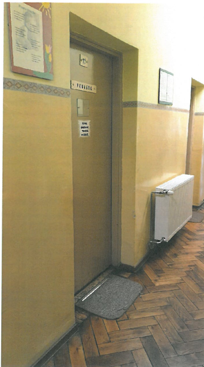
Fot. 1. Widok drzwi wewnętrznych pomiędzy pomieszczeniem komunikacji, a pomieszczeń wewnętrznych, przeznaczonych do demontażu i ponownego montażu nowych drzwi w miejsce zdemontowanych.
